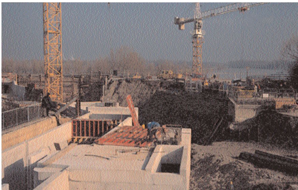
Vue sur le chantier de construction de la passe à poissons en amont de la chute d'Iffezheim, 1999
