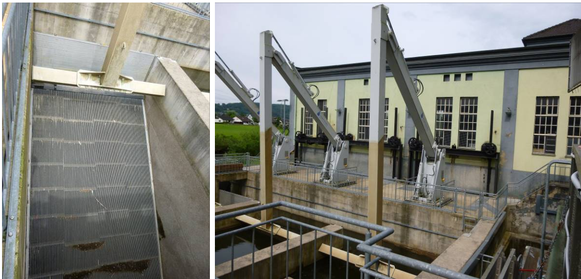
Figure 8 : grille verticale (10 mm) du dispositif de dévalaison installé sur l'usine hydroélectrique d'Unkelmühle.
